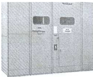
Fig. 1 Subestación compacta S2
